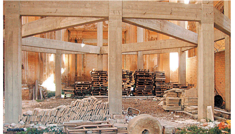
■ Armazón llevado a cabo en la reforma de 1981. Nada más. El interior está lleno de escombros y material de construcción. O. N.
